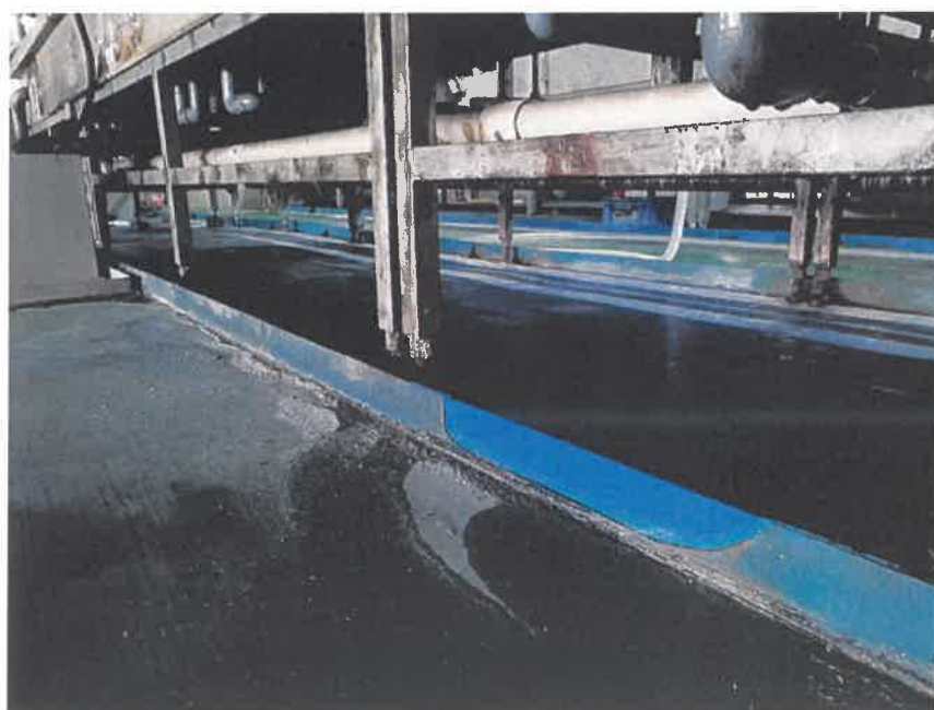
图 13-2 规范设置电镀生产线防泄漏应急措施
